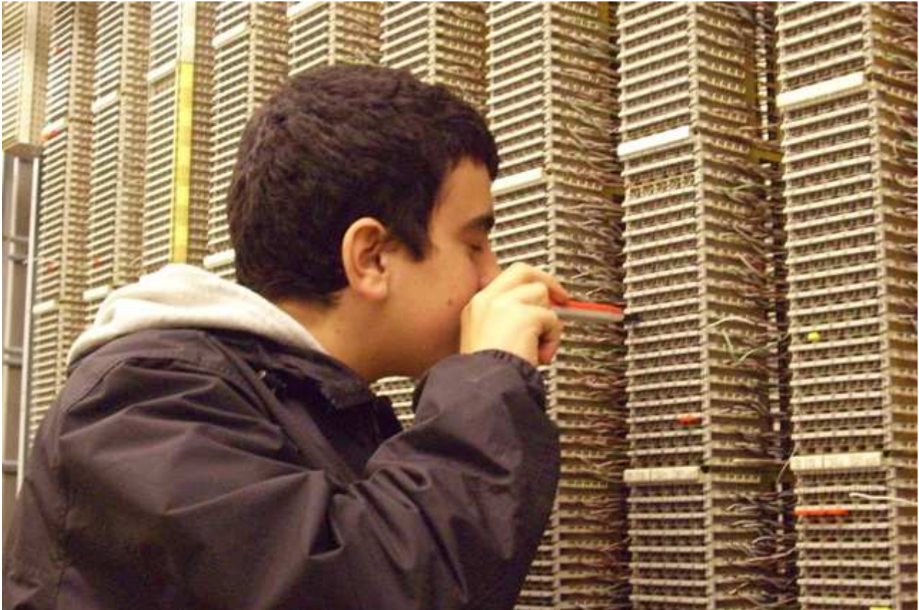
Alejandro an einer Schaltzentrale
